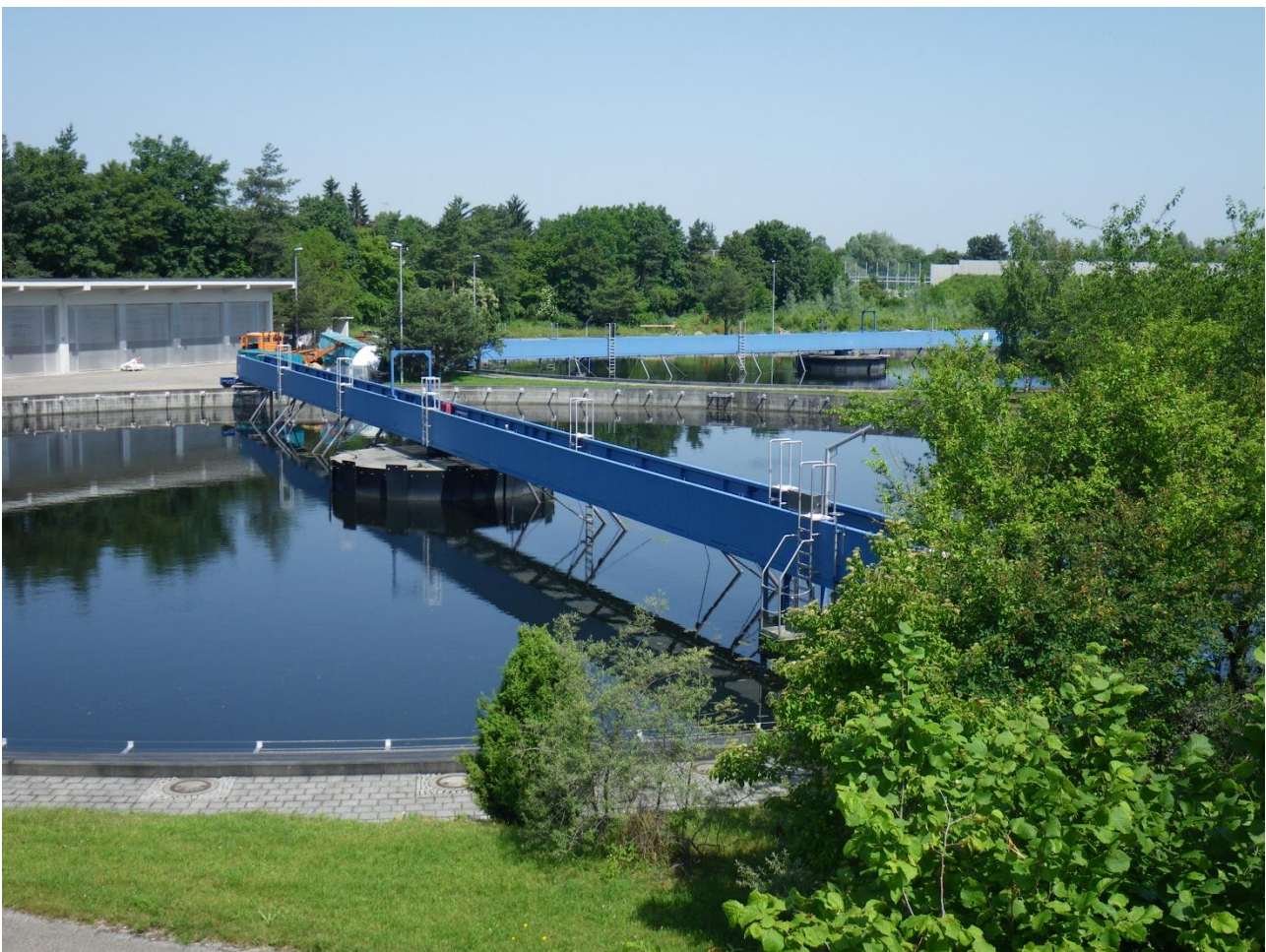
Kläranlage Stadtentwässerung Augsburg (Quelle: Stadt Augsburg)
