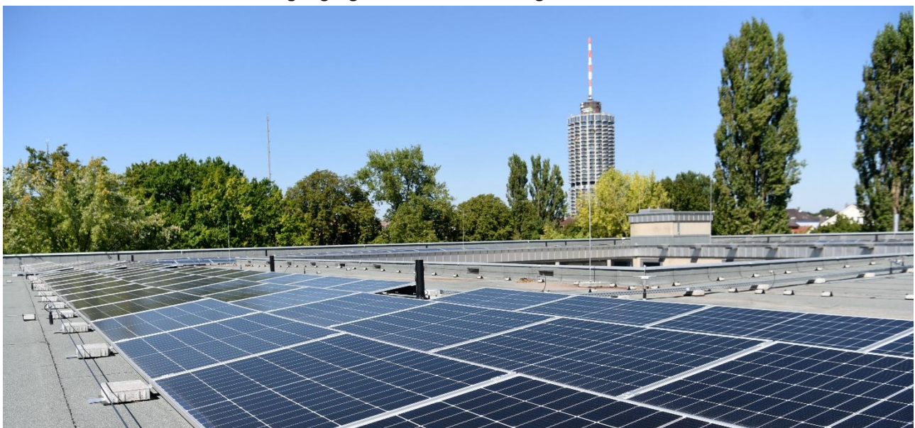
Photovoltaikanlage auf dem Gymnasium bei St. Anna (Quelle: Ruth Plössel)
